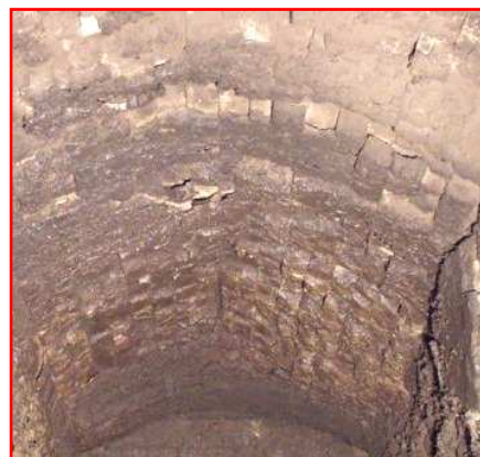
Poškození vyzdívkou spalovacího kotle na dřevní odpad – důsledek reakce s alkáliemi a koroze taveninou
